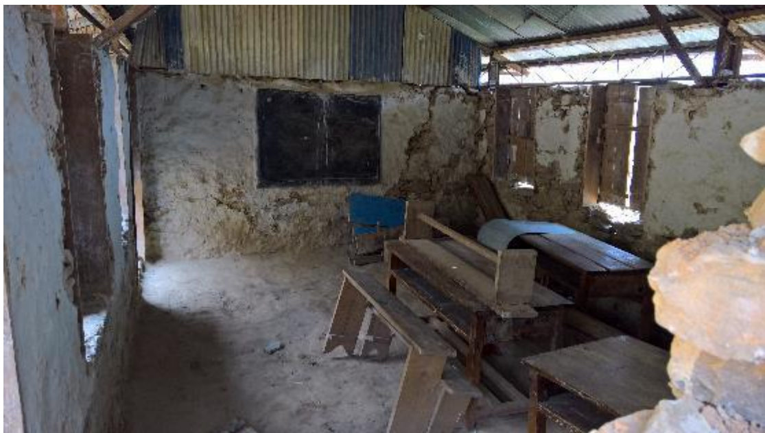
Figura 2: interno di uno dei due edifici della scuola di Kanku semidistrutti dal terremoto del 2015
