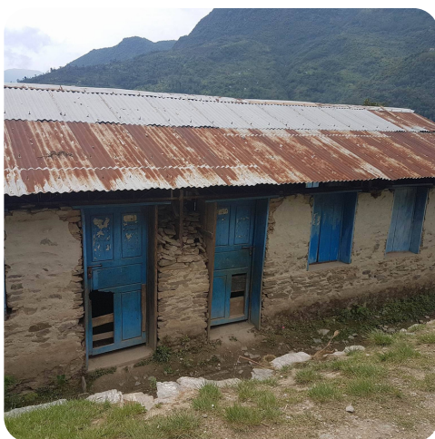
Figura 1: Edificio pericolante della scuola di Kanku
